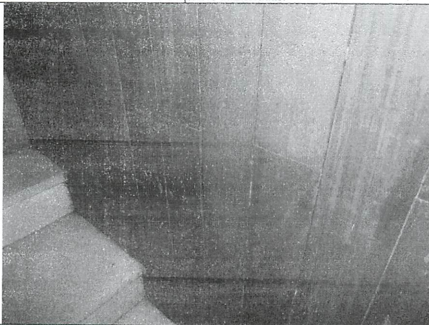
Painel de folheados em madeira: visão de partes danificadas. Dimensões: 3,76 x 4,23 metros.
