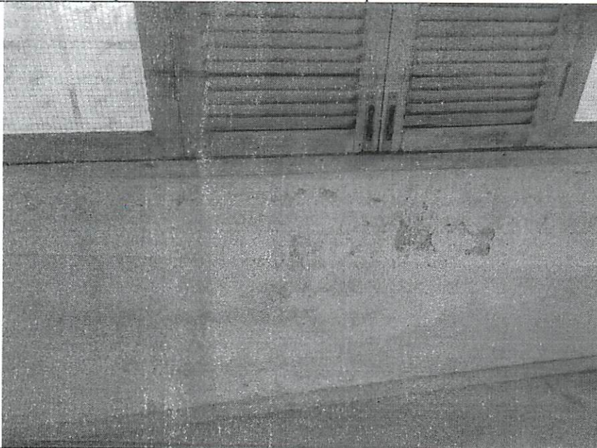
Sala 2: revestimento de parede danificado.
