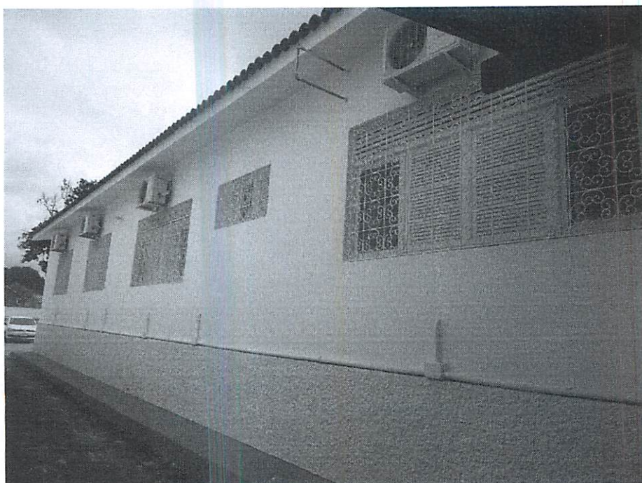
IMAGEN: 12 - ÁREA EXTERNA COM EQUIPAMENTO PRÉ INSTALADO
